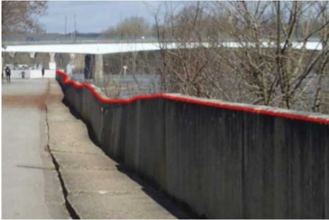
Mur partiellement basculé – rive gauche
